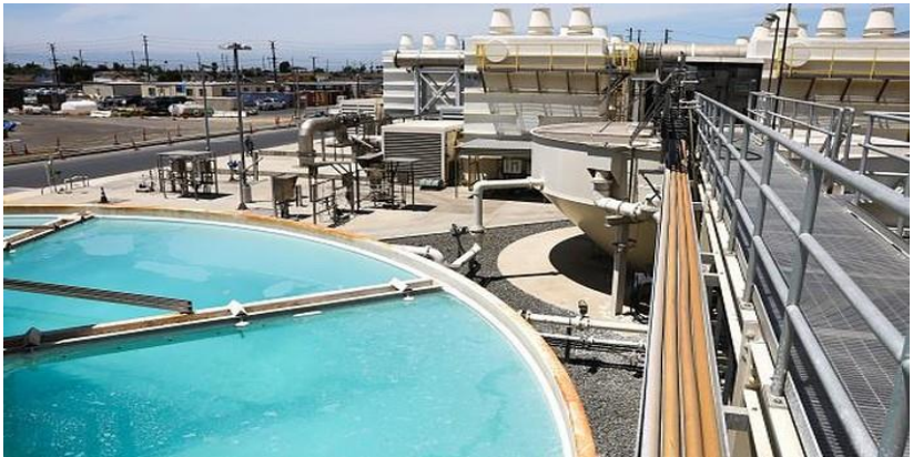
Gambar 2.24 Pabrik Gwrs Di California Merupakan Pabrik Daur Ulang Air Limbah Terbesar Di Dunia. Pabrik Ini Mampu Menghasilkan 100 Juta Galon Air Minum Bersih Setiap Hari
