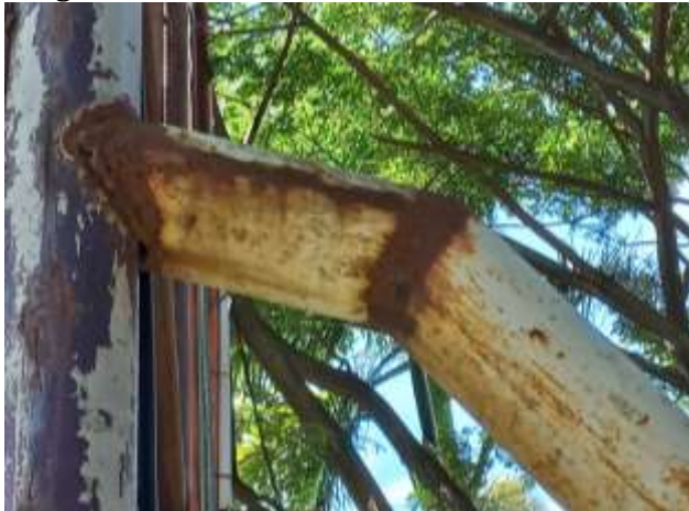
Gambar 8.4 : Korosi pada konstruksi (Sumber: Penulis)
