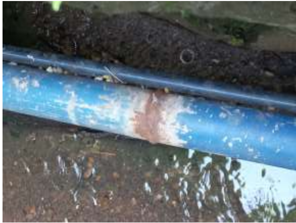
Gambar 8.3 : Korosi pada sambungan pipa air (Sumber: Penulis)
