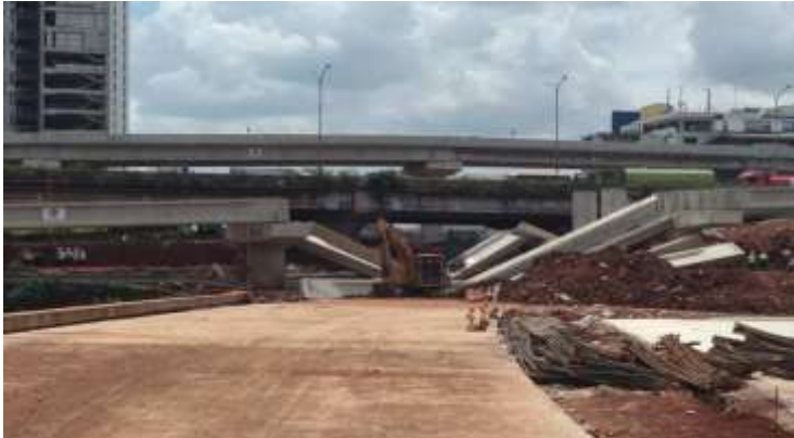
Gambar 8.12 : Jembatan Tol Depok-Antasari roboh, Selasa (2/1/2018).
