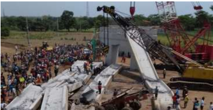
Gambar 8.10 : Empat Girder jatuh saat pembangunan jalan Tol Pasuruan Probolinggo di kecamatan Grati Pasuruan Sumber : https://www.tribunnews.com / Choirul Arifin
