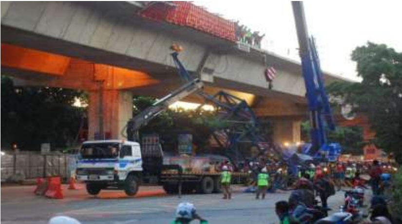
Gambar 8.9 : Sejumlah pekerja proyek Tol Bogor Outer Ring Road (BORR) dari PT Wijaya Karya sedang mengevakuasi tower crane portable yang terjatuh saat pemasangan barrier pembatas jembatan
