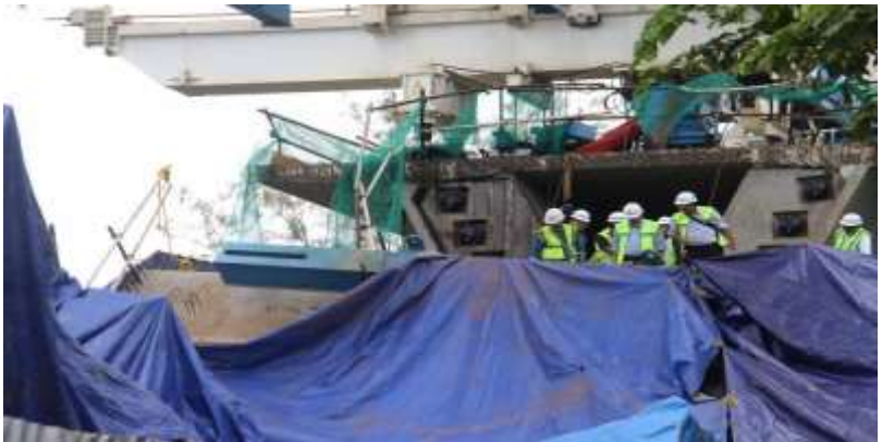
Gambar 8.13 : Petugas mengecek kondisi pasca robohnya kontruksi proyek LRT di Jalan Kayu Putih, Pulogadung, Jakarta Timur, Senin (22/01/2018). https://properti.kompas.com /Maulana Mahardhika
