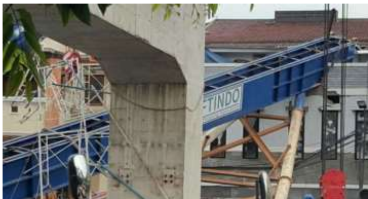
Gambar 8.8 : Crane Proyek LRT Roboh Timpa Ruko di Kelapa Gading
