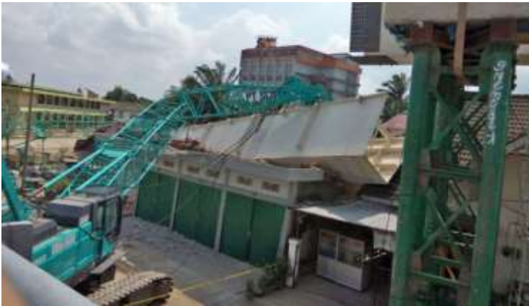
Gambar 8.6 : Jatuhnya alat berat Boom Crane LRT Palembang
