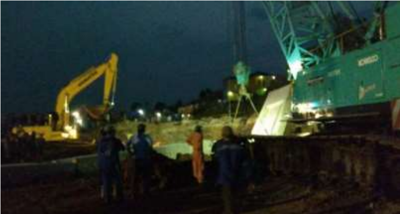
Gambar 8.7 : Ambruknya Jembatan Tol Penyeberangan Orang (Jembatan Over Pass ) pada proyek Jalan Bebas Hambatan atau Tol Bogor-Ciawi-Sukabumi (Bocimi) Sumber : radarcirebon.disway.id / Dian Arief Setiawan
