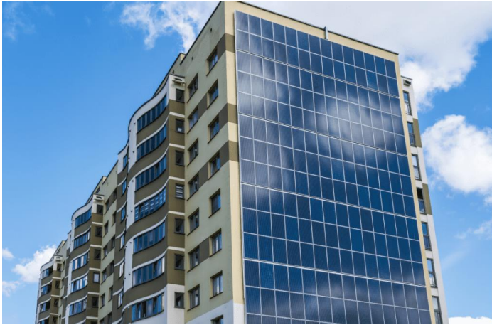
Gambar 9.8. Panel Photovoltaic dipasang pada dinding bangunan berlantai banyak (Sumber : hoymiles.com)
